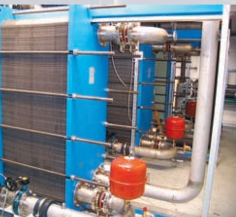
Центральный охладитель для стенда испытаний моторов
