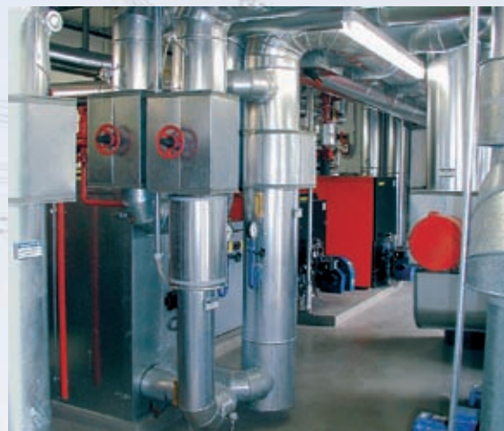
ПТО в системах отопления
