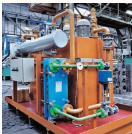
Охлаждение машинного масла в металлопрокатной промышленности
